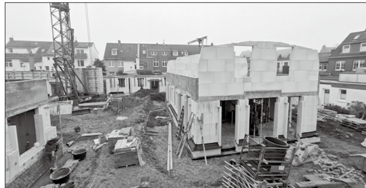
Die Arbeiten an den Gebäuden der sogenannten Gartenstadt schreiten planmäßig voran. Foto: Sykora
