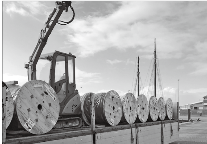
Ab Oktober soll es mit dem Ausbau des Glasfasernetzes weitergehen. Foto: Stadtwerke Norderney
