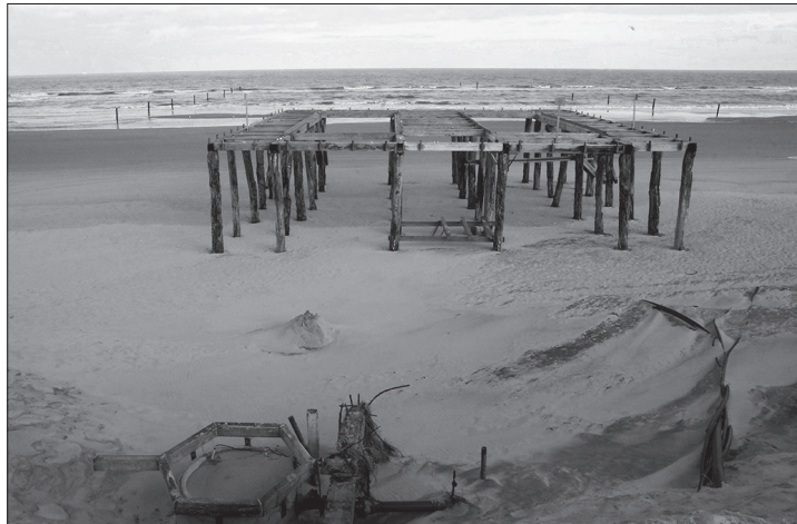
Der Strand an der Weißen Düne wurde im Winter noch einmal stark abgetragen. Nun soll erst einmal die Plattform erneuert werden. Foto: Linke
