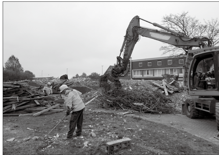
Nur noch Schutt ist von dem alten Kasernenhaus im Gebiet an der Mühle übrig. Foto: Sykora
