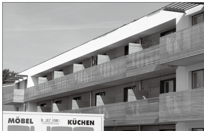
Derzeit liefert und montieren Mitarbeiter des Möbelhauses die Küchen, die in allen Apartments eingebaut werden. Foto: Sykora
