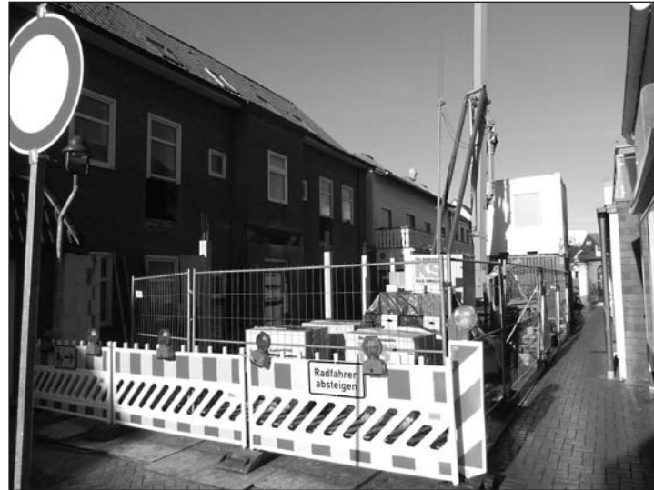
Amtlich versiegelt: an dieser Baustelle darf fürs Erste nicht weitergebaut werden
